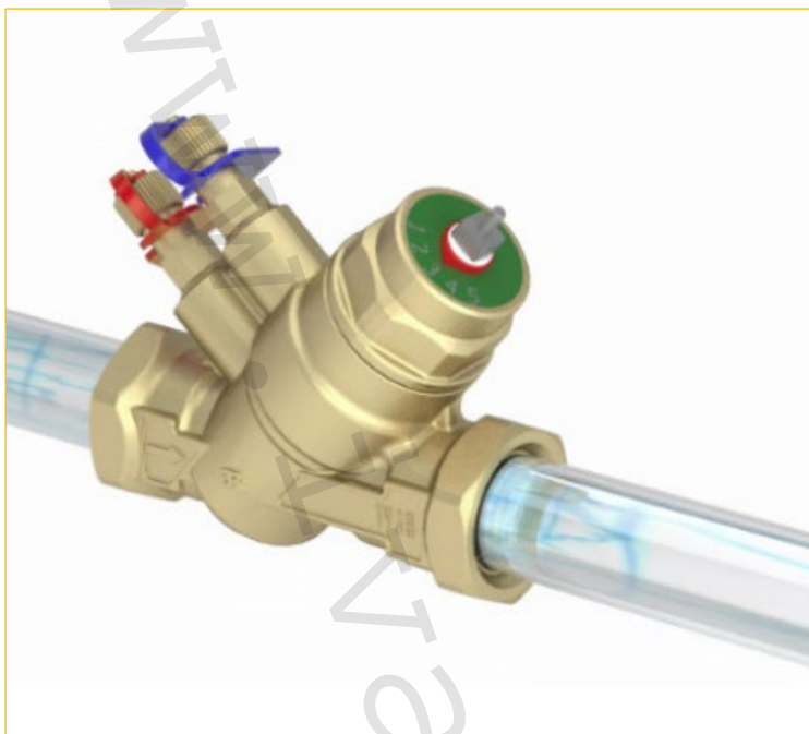
a) Vyvažovací ventil instalovaný v provozním systému
